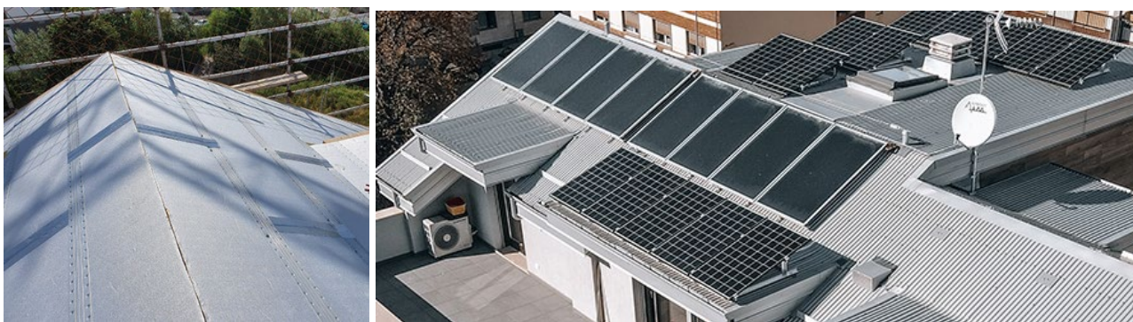
Copertura dell'edificio con Isotec Linea e dopo l'applicazione delle lamiera metalliche grecate.
